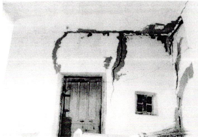
udvari homlokzat, repedés
